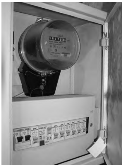
Рис. 5. Внешний вид открытого электрощита (шкафа) с расположенными внутри выключателями-автоматами
